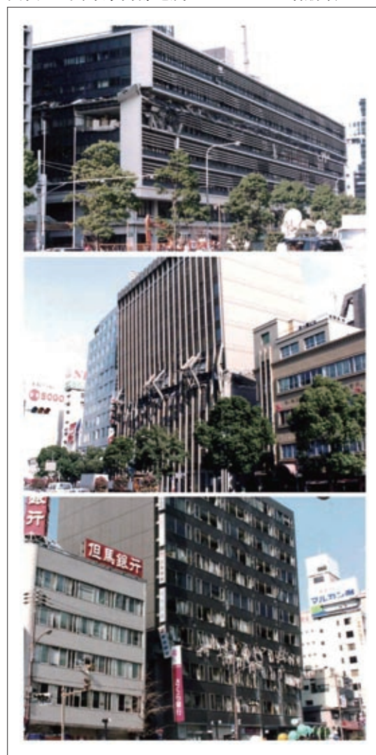
図表9 兵庫県南部地震によるビルの層崩壊
