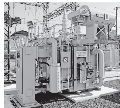
図表2 66kV、5MVA 環境調和型変圧器の設置例
