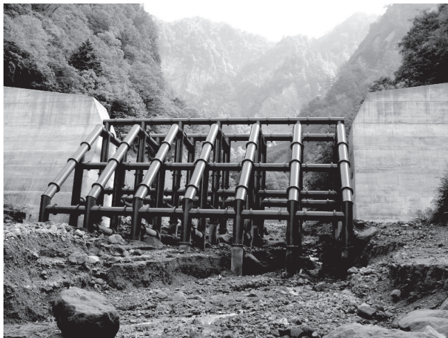
図表9 鋼管型砂防堰堤
