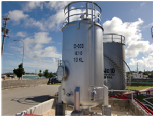
E10燃料貯蔵タンク
