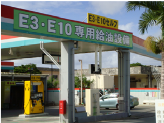
JA Ohtsuka E3・E10セルフ給油設備
