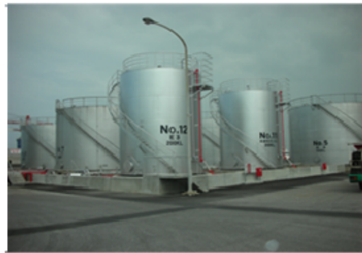
未納税ガソリンタンク、E3燃料貯蔵タンク
