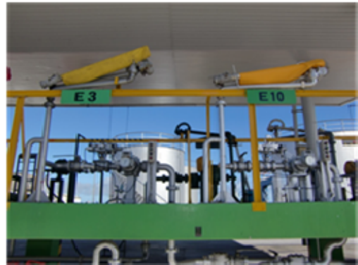
E3・E10燃料出荷設備
