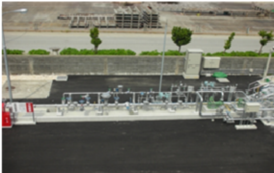
E3燃料混和設備ライン
