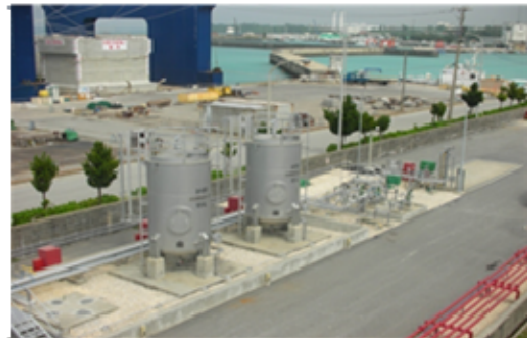
エタノール貯蔵タンク、高濃度混和設備
