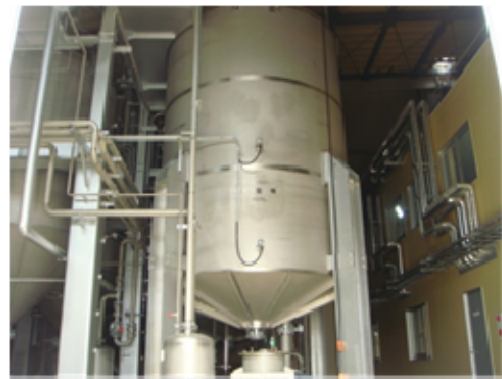
原料調整槽(40kL)
